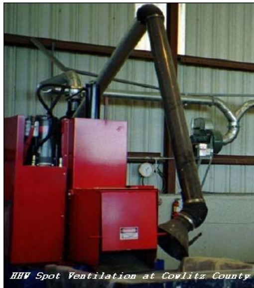
Ventilation locale connectée à un filtre HEPA
